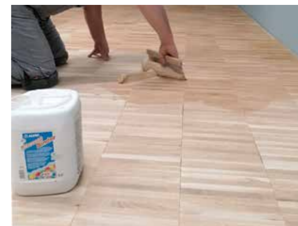
La grande sala polifunzionale al piano terra ha un pavimento in parquet posato con ULTRABOND P990 1K e verniciato con ULTRACOAT HT 2K.
