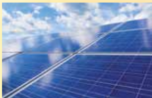
Revêtements avec installation photovoltaïque
