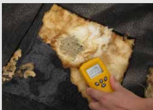
Carotaggio: la lana di vetro non è stata fissata al supporto e si presenta totalmente imbibita (umidità del 100%)
