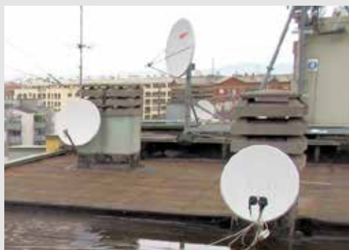
Antenne con cavi passanti attraverso lo strato impermeabilizzante
