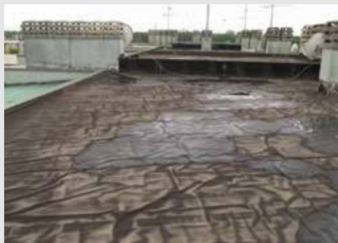
Stato di fatto: reptazione (corrugamento) e ristagni d'acqua
