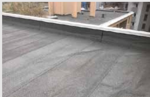
Stato di fatto: visibili segni di reptazione
