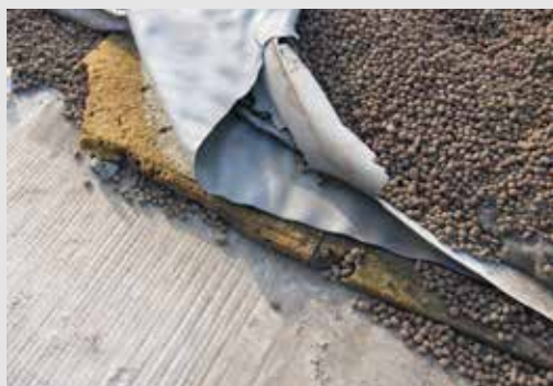
Stratigrafia preesistente con manto in PVC-P e isolante ammalorati
