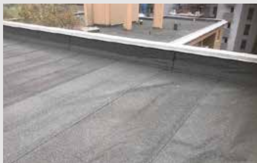
Stato di fatto: visibili segni di reptazione
