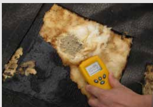
Carotaggio: la lana di vetro non è stata fissata al supporto e si presenta totalmente imbevibile (umidità del 100%)
