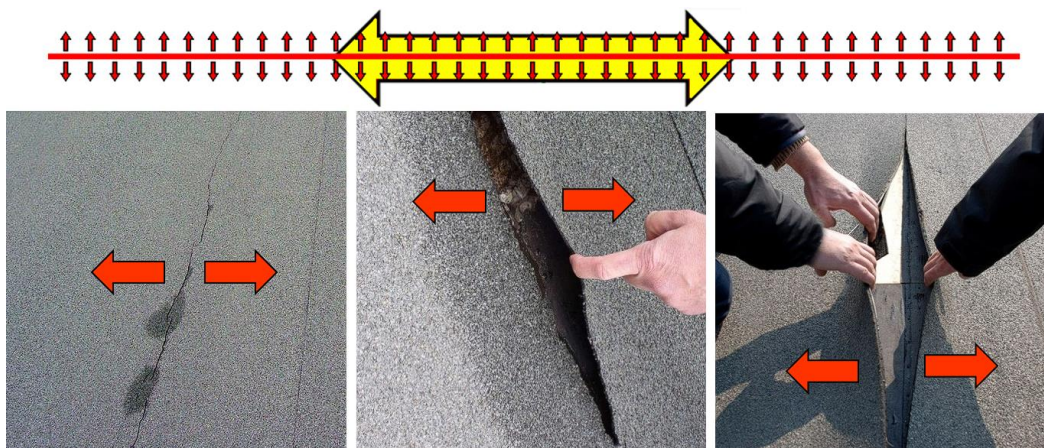
Errore di direzionalità dei teli delle membrane dell'elemento di tenuta, rispetto alla direzione di posa e sfalsamento dei pannelli termoisolanti.
