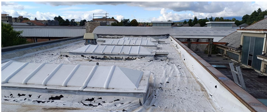
Scelta non corretta della tipologia e spessore di membrana sintetica, unitamente alla mancanza di vincolo e protezione (alla grandine) del sistema impermeabile.
