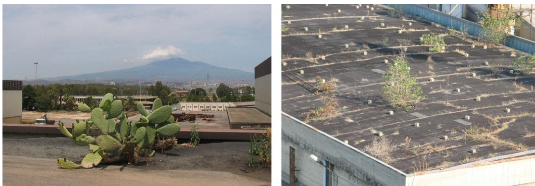
Mancanza di manutenzione della copertura impermeabile.
