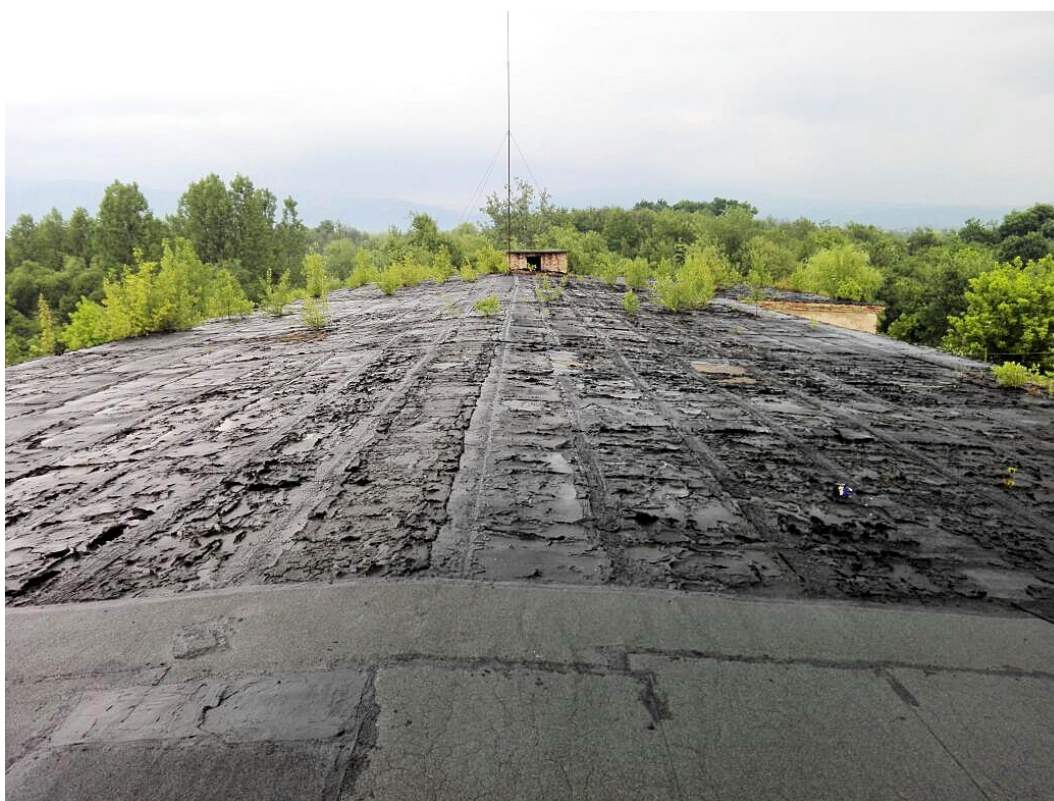
Sistema impermeabile realizzato con membrana non stabile all'esposizione solare (errore di scelta di prodotto).
