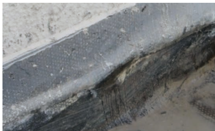
Deformazione dell'impermeabilizzazione del risvolto verticale e lacerazione della membrana alla quota della pavimentazione, causate da mancanza di elemento comprimibile perimetrale
