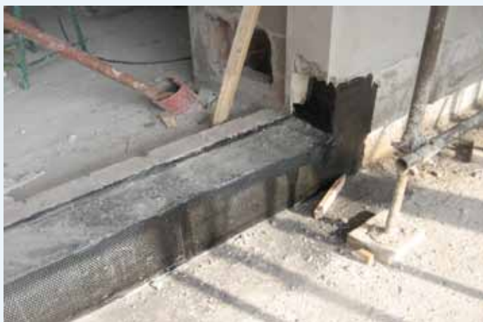
Realizzazione di vaschetta sotto soglia, con contenimento laterale sulle spallette e contenimento posteriore sullo spessore di un cordolo di cemento appositamente predisposto.
