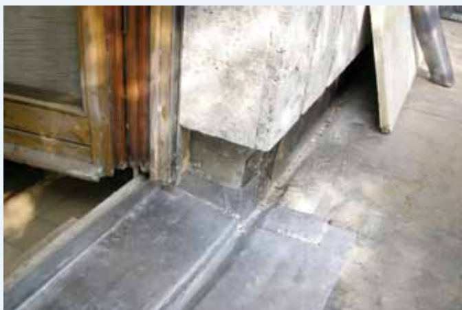
Rifacimento d'impermeabilizzazione sotto soglia con realizzazione di vaschetta in piombo, con contenimento posteriore e laterale
