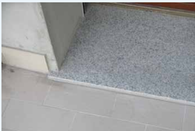
Soglia completata, con contenimento esterno rilevato di circa 20 mm, rispetto alla quota della pavimentazione
