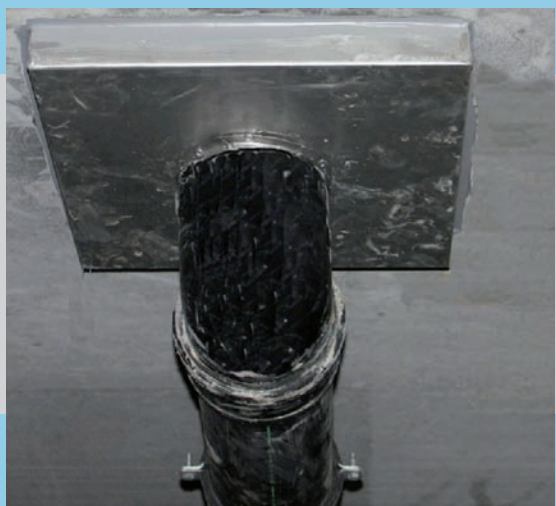
Lo stesso scarico dopo l'intervento "miracoloso" di Santa Cassetta Raccogliatrice, protettrice degli Impermeabilizzatori.
