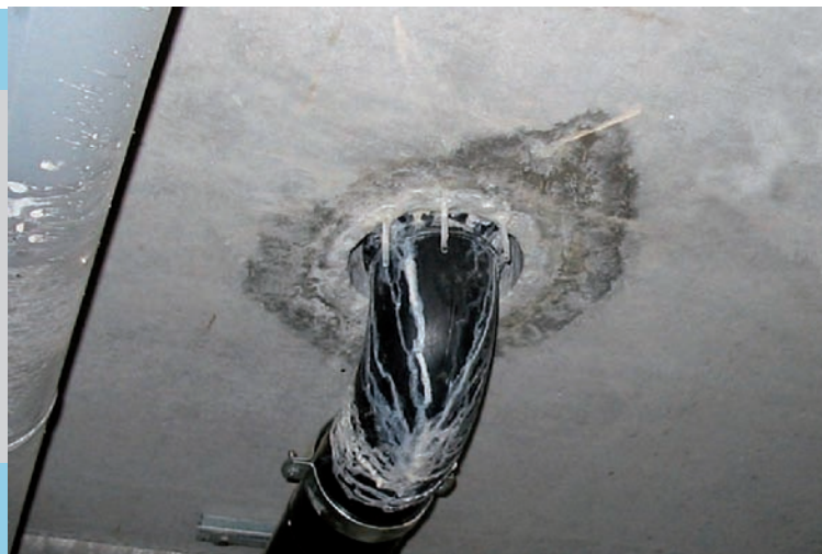
Immagine di uno scarico con problemi d'infiltrazione al contorno del foro di passaggio.
